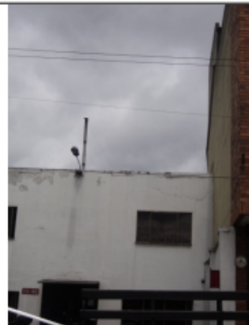
FOTOGRAFÍA 4. DUCTO DE LA CALDERA
