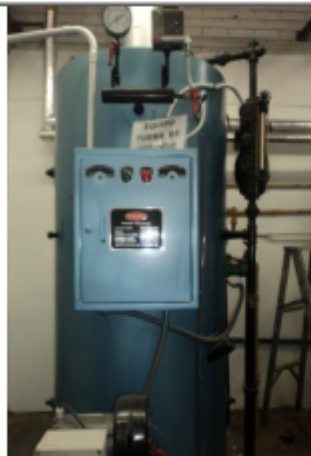
FOTOGRAFÍA 3. CALDERA FUERA DE FUNCIONAMIENTO
